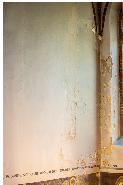
Wasserschäden in der Gedenkkapelle
